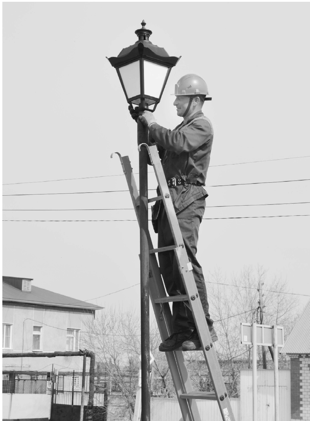
Мемориальный комплекс в райцентре освещен новыми фонарями. В. В. Налесников работает над подключением одного из них.
